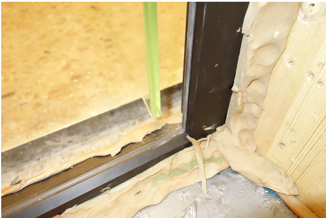
Bild 5 – Dörren vid mätningarna i bilaga 2 (55.2).
