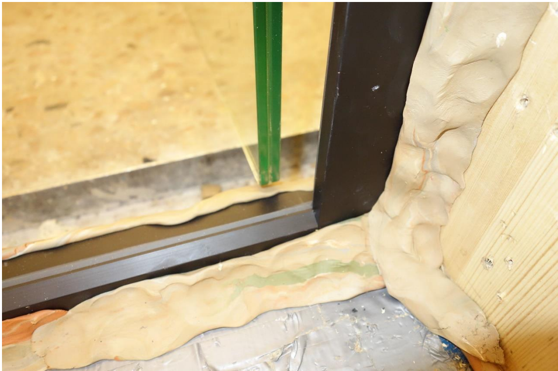
Bild 4 – Dörren från mätningen i bilaga 1 (66.2) sedd från insidan. Ena nedre hörnet.
